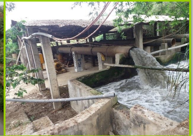
TUBERÍAS DE SUCCIÓN
