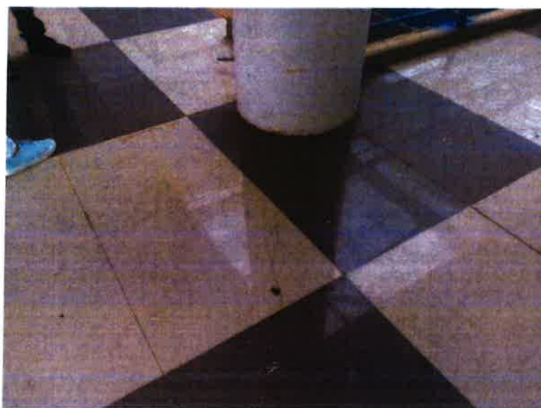
Foto N°03: Pisos de porcelanato con fisuras.
