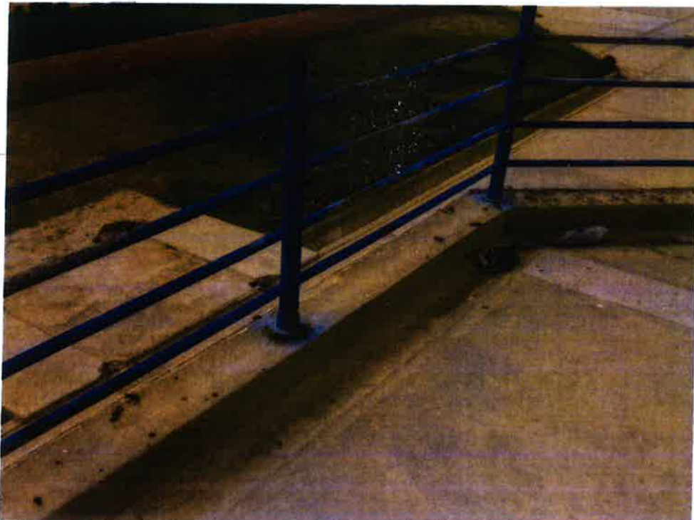
Foto N°28: Pasamanos metálicos en mal estado, con fisuras en la base y corrosión en su estructura.
