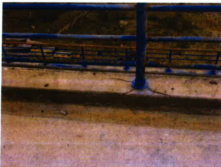
Foto N°26: Pasamanos metálicos en mal estado, con fisuras en la base y corrosión en su estructura.
