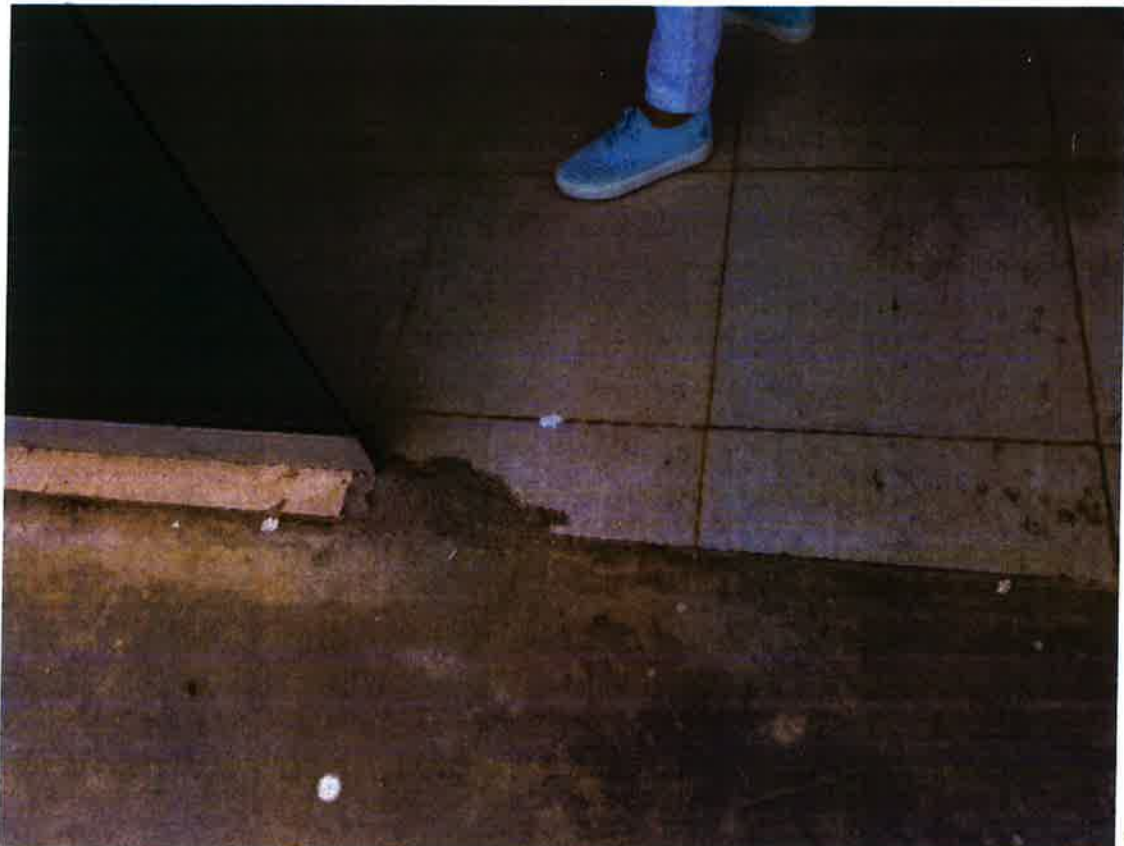
Foto N°05: Pisos de cerámico en estand, en mal estado (Roto y agrietado).
