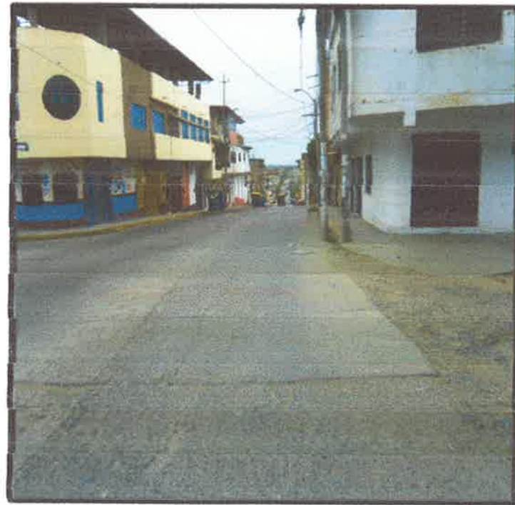
Foto N°06 y 07: se puede identificar en la siguiente imagen que existentes desgastes en la losa de rodadura, desplazamiento de paños, agrietamiento entre otros
