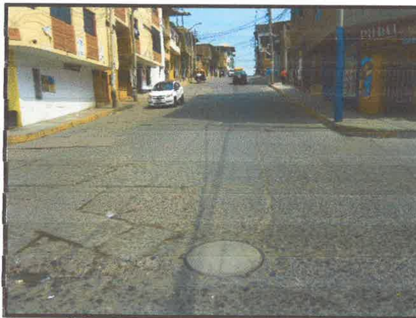
Foto N°04: se puede identificar en la siguiente imagen que existentes fisuras de esquina en algunos paños, además de fisuración trasversales media, y desgaste de superficie.
