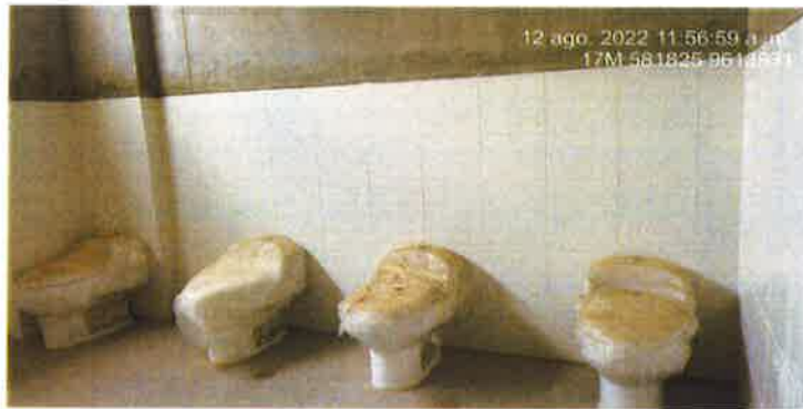
Bloque 4 Ss Hh, falta ejecutar acabados y separadores de Melamine
