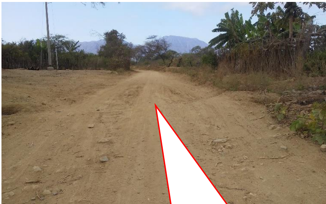
Erosión hídrica que genera el socavamiento y derrumbe de la estructura lateral de la vía
