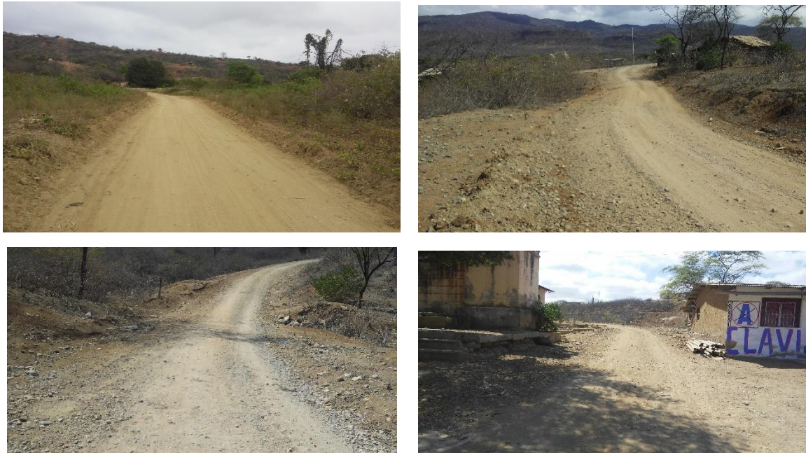
Figura N°03: Vía sin drenaje pluvial
