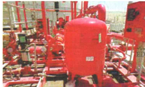
SKID Sistema Contra Incendio Cliente: Marcobre
