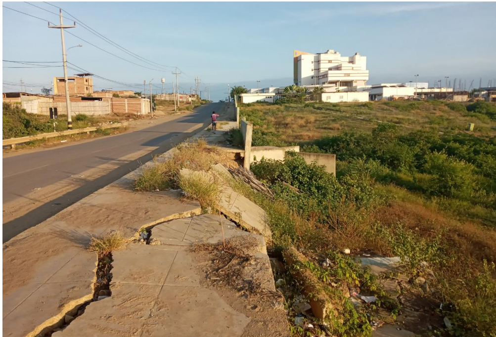
Figura 12-1: Perímetro del Hospital Regional de Tumbes Colapsado
