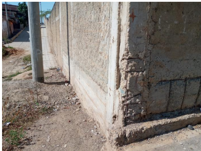
Figura 3-3: Cerco perimétrico afectado por sulfatos de la brisa marina
