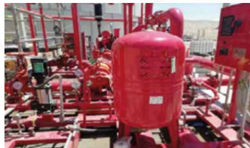
SKID Sistema Contra Incendio Cliente: Marcobre
