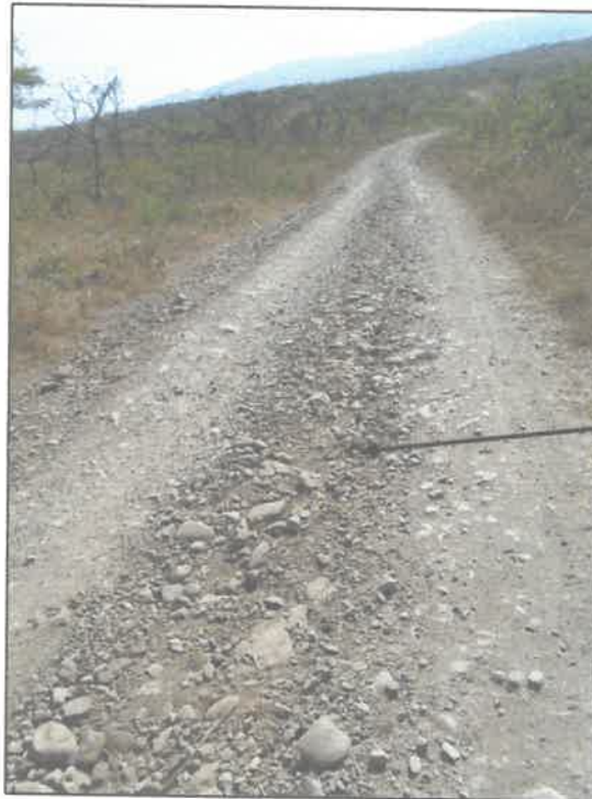
VIA EN MAL ESTADO
