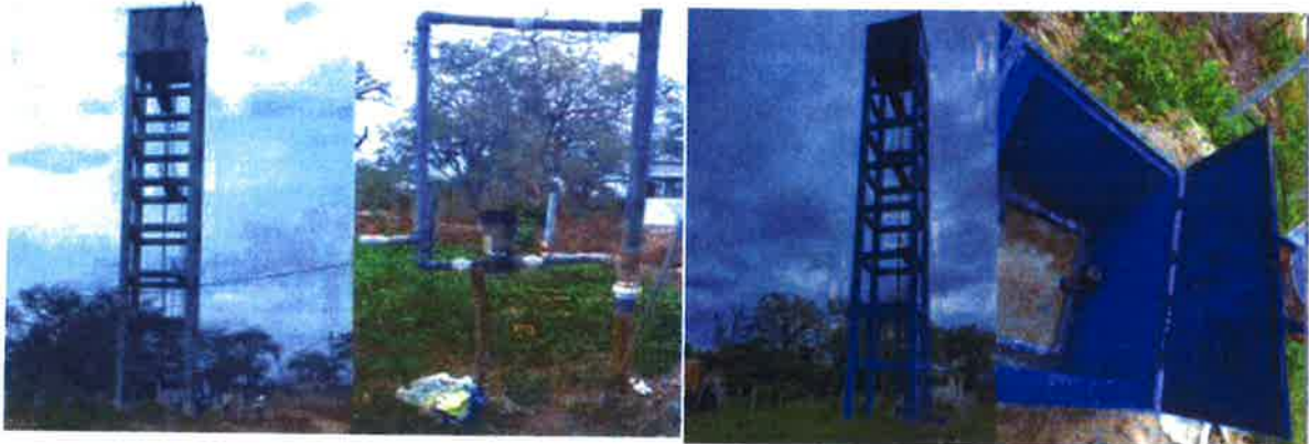
Sistema de Agua Potable Lechugal
